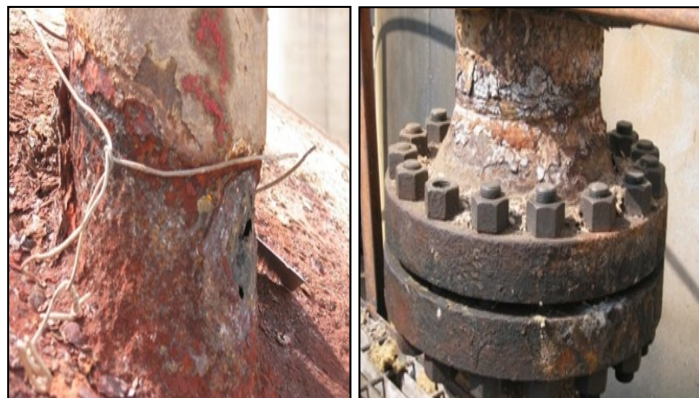
خوردگی شدید قسمت‌های عایق شده تجهیزات
